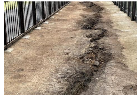
地表地震断層
